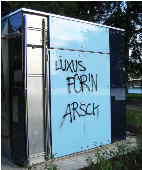
Abb. 2 Beschädigung der gebührenpflichtigen Toilette im Park (Quelle: Anja Joos)
